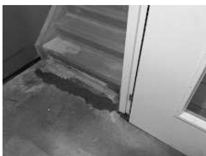
lekwater hydr.f.ruimte naar trappenhal.JPG 1925K
