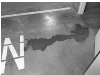
lekkage hydr.f.ruimte naar garage.JPG 1701K
