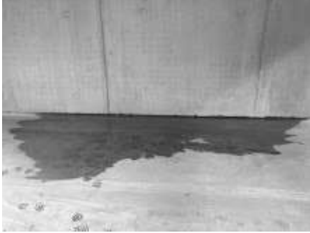
Lekkage west.JPG 1788K
