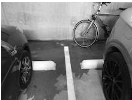
Lekkage noord 4.JPG 1938K
