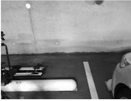
Lekkage noord 1.JPG 1685K
