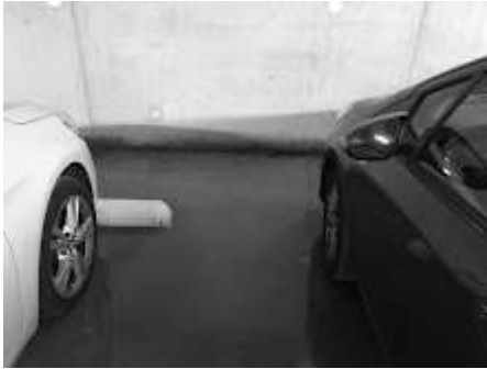
Lekkage noord 3.JPG 1645K
