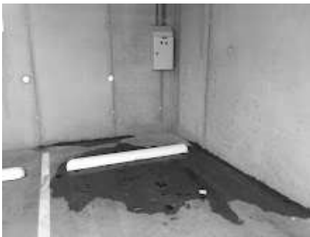
Lekkage noord-oost.JPG 1578K
