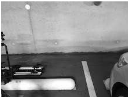
Lekkage noord 1.JPG 1685K
