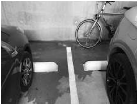
Lekkage noord 4.JPG 1938K
