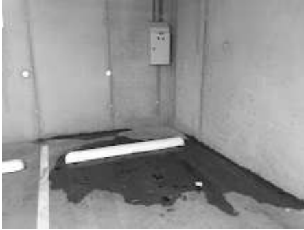
Lekkage noord-oost.JPG 1578K
