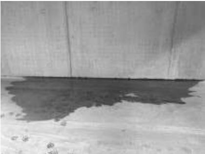
Lekkage west.JPG 1788K
