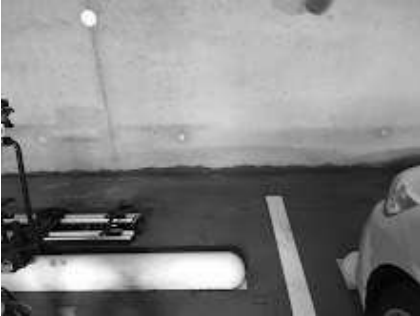
Lekkage noord 1.JPG 1685K
