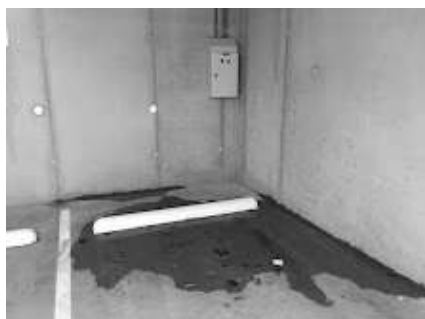
Lekkage noord-oost.JPG 1578K
