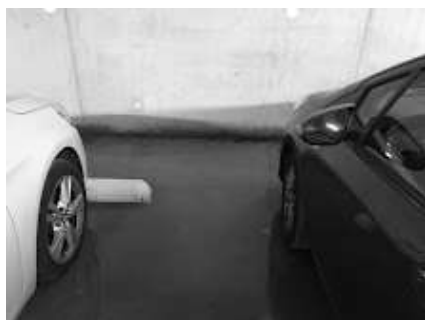
Lekkage noord 3.JPG 1645K
